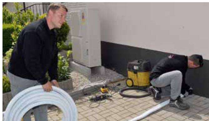
Cała instalacja systemu Ecodan pracuje bez problemu dzięki całkowitej modernizacji instalacji c.o.
