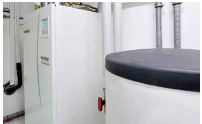
Instalacja grzewcza we wnętrzu budynku zajmuje mniej miejsca
